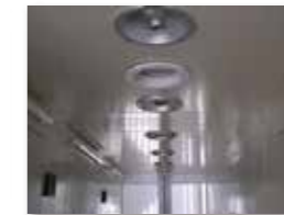
⑤天井吹出しパンカー
